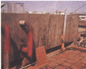
缺點：建築物水塔通氣孔、溢流管、排水管未裝設防蟲網實例
