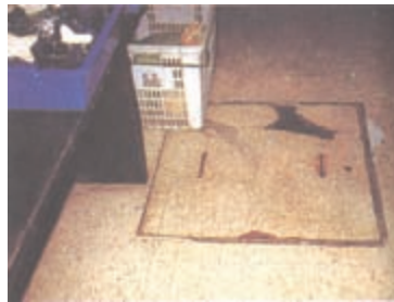
缺點：為利通行，將蓄水池人孔蓋突緣打掉並堆置雜物，容易污染蓄水池水質
